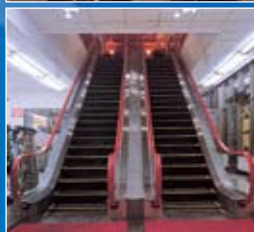
ESCALATOR エスカレーター
